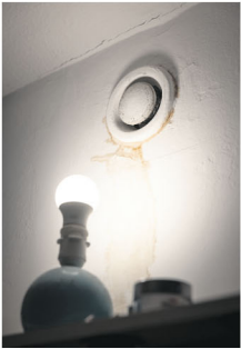
Feuchte Wand in einer Hölk-Wohnung
